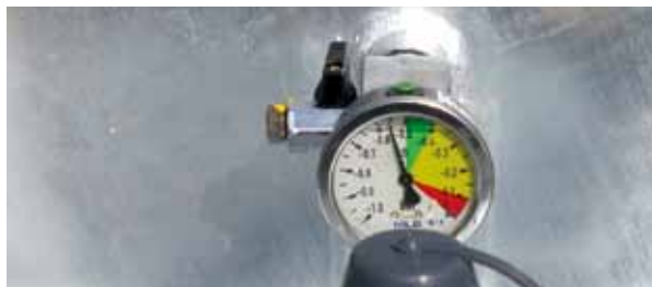
Surveillance des fuites de vide
